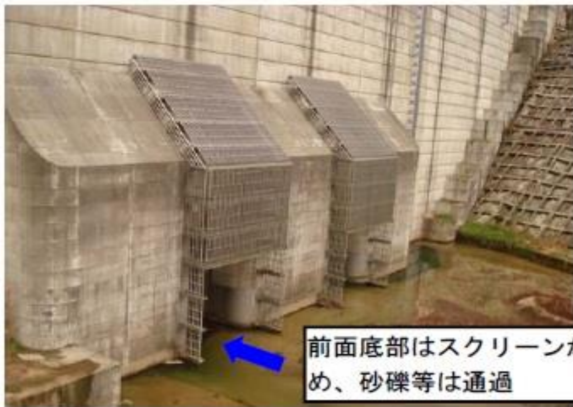
写真ー4 益田川ダムスクリーン例
