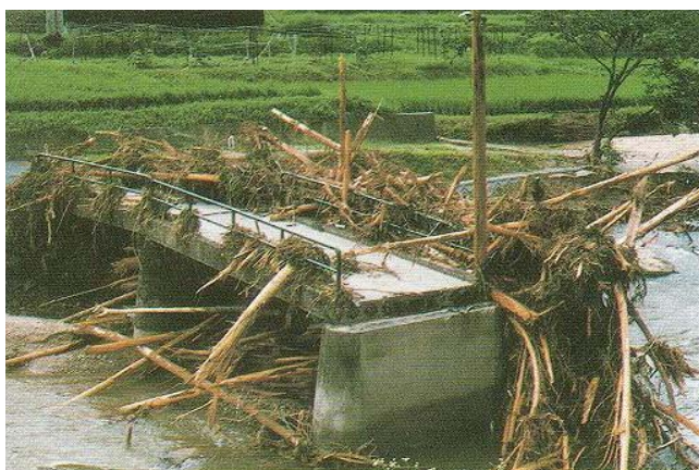
図-2 橋梁に埋塞した大量の流木
