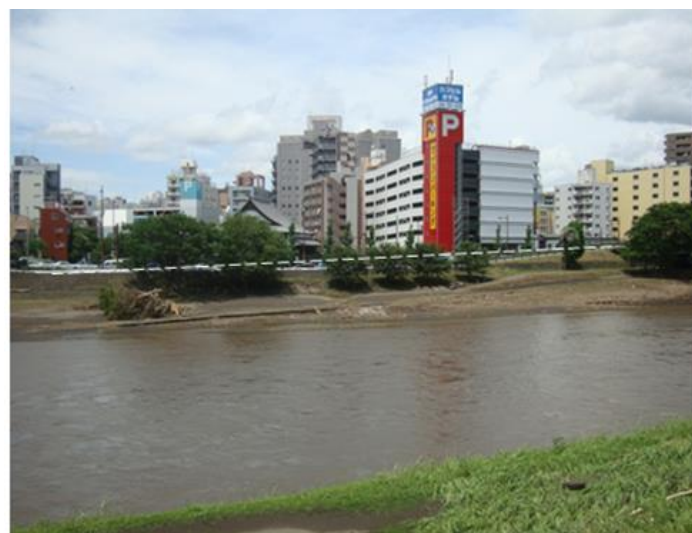
写真1 一部が低くなった右岸堤防(13.6K 付近)
