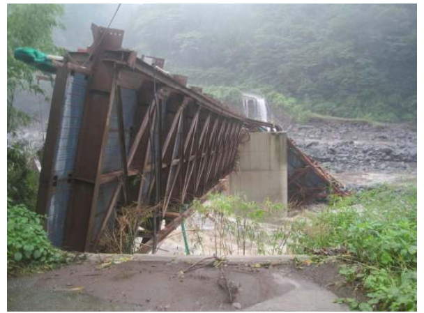
工事用仮橋も流失 2012年7月14日撮影
