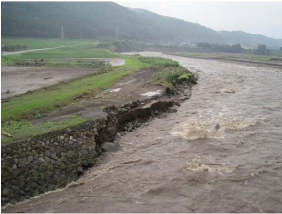
古いコンクリート製の護岸がこわれている(内牧橋下流) 2012年7月14日撮影
