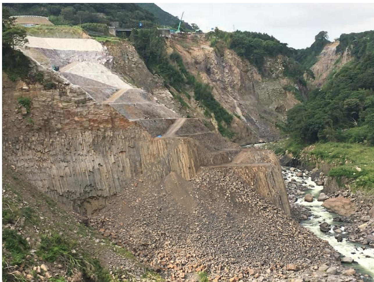
破壊された柱状節理(2017年8月30日撮影)
