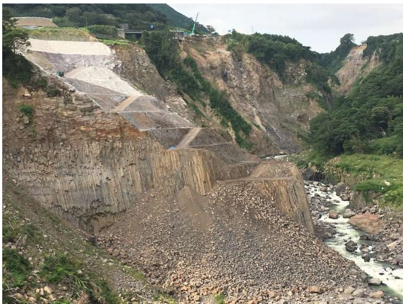
破壊された柱状節理(2017年8月30日撮影)
