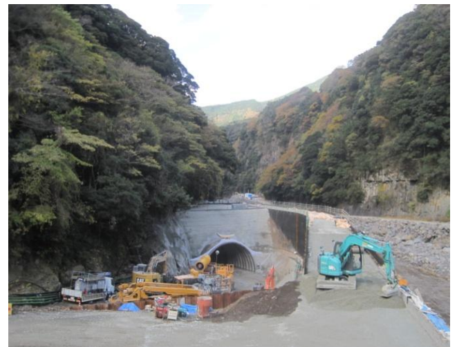
立野ダム仮排水路トンネル工事の状況。写真手前が上流側。奥のV字谷に立野ダムが建設されようとしている 2014年11月22日撮影
