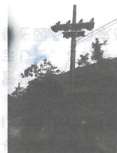
⑨ 瀬戸石ダム下流 左岸の警報局
