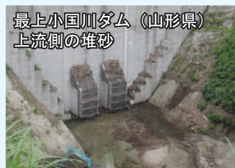
最上小国川ダム（山形県）上流側の堆砂
